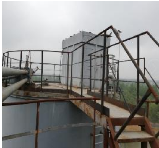
灰库顶部脉冲除尘器
