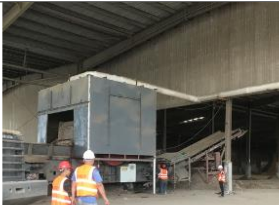
原料破碎设备
